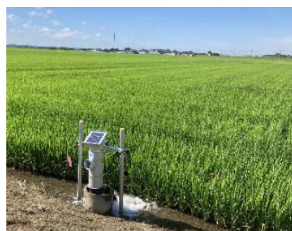
【自動給水栓の導入（鶴岡市）】
