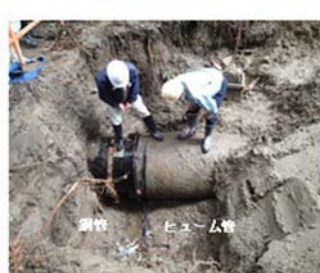
パイプラインの継ぎ目破れによる漏水
