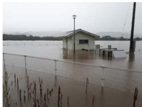
【揚水機場の浸水被害 (R2 : 白鷹町)】
