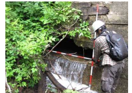
堤体底部の抜け
