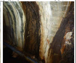
排水トンネルの劣化
